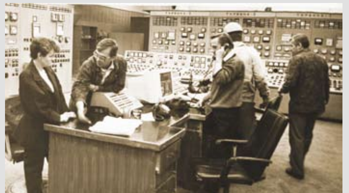
Главный пульт управления ТЭЦ Сыктывкарского ЛПК.
