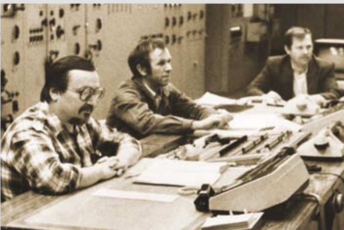
Главный щит управления.
