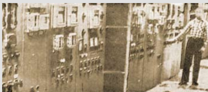
Пульт управления автоматикой теплотехнического цеха завода ДВП.
