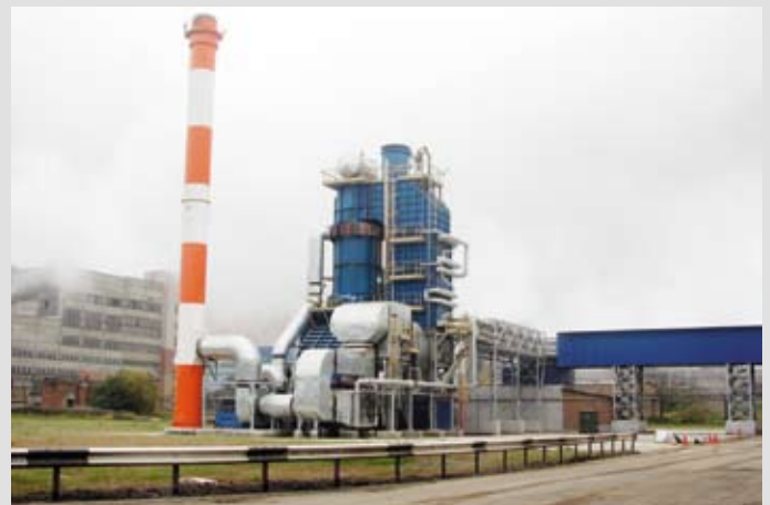
Установка нагрева термоасла работает на древесных отходах (Classen/Германия).
