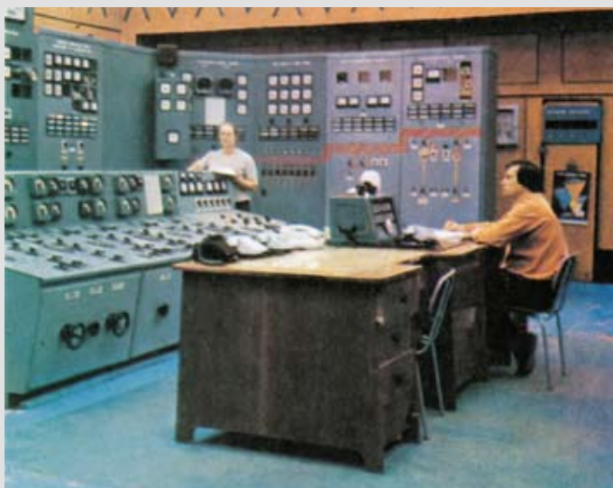
Главный пульт ТЭЦ.
