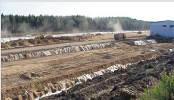
Земляные работы, вывоз грунта, укладка геополотна, отсыпка песчаного основания на строительстве завода. Июль 2009 г.
