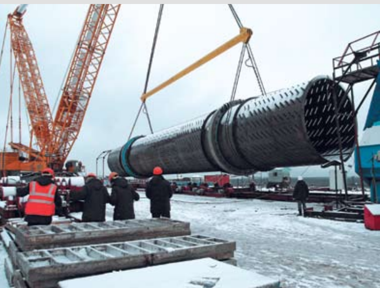
300 тонн в воздухе. Окорочные барабаны нового цеха приготовления древесного сырья с ювелирной точностью установлены на опорные катки. Самые большие барабаны в мире готовы к работе.
