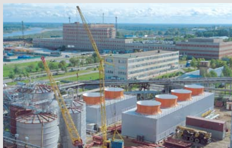
Возведение новой выпарной станции – важный этап в постоянной работе предприятия по сокращению водопотребления.
